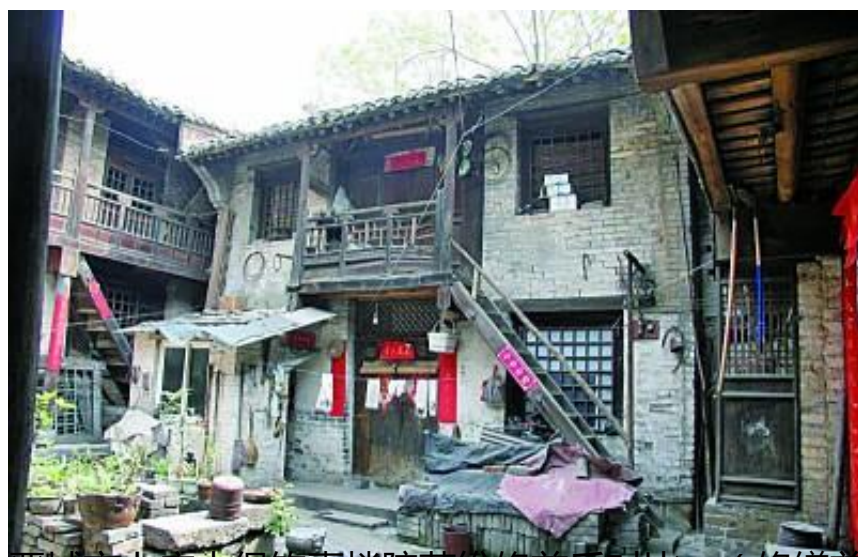
晋城市上庄古堡钦嘉楼院落维修前后对比。（修缮前）资料图片
